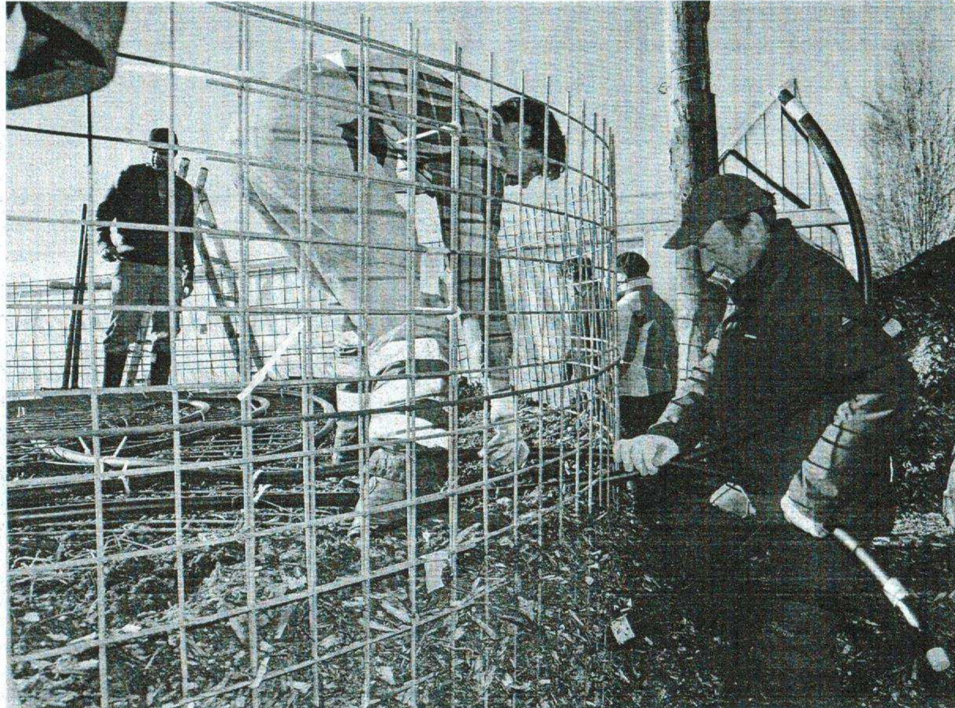
Die wasserführenden Rohre, die im Abstand von einem halben Meter in den Komposthaufen eingelegt wurden, führen die Wärme aus dem Innern ab. Rechts Ruedi Aschmann.
